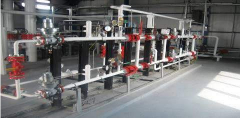
Şekil 11. Yardımcı Binalar Gaz Skid
