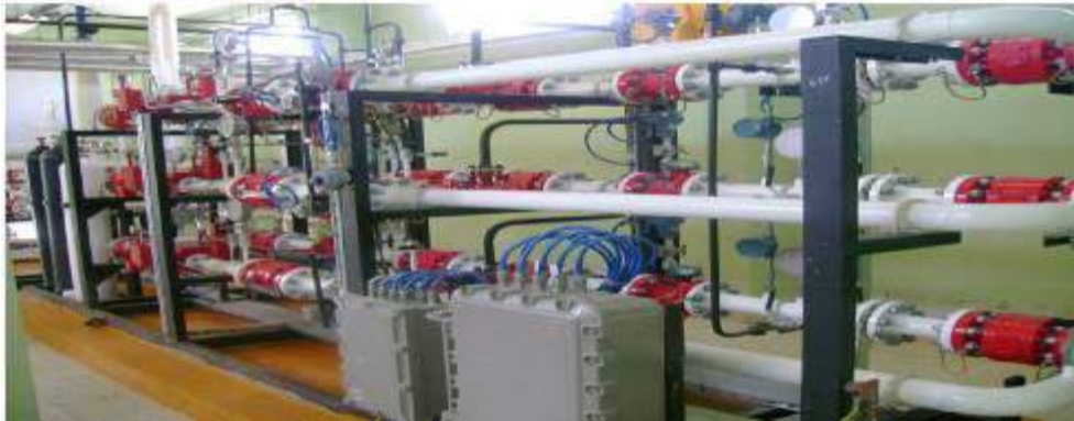
Şekil 10. Türbin Fuel Gaz Skidi
