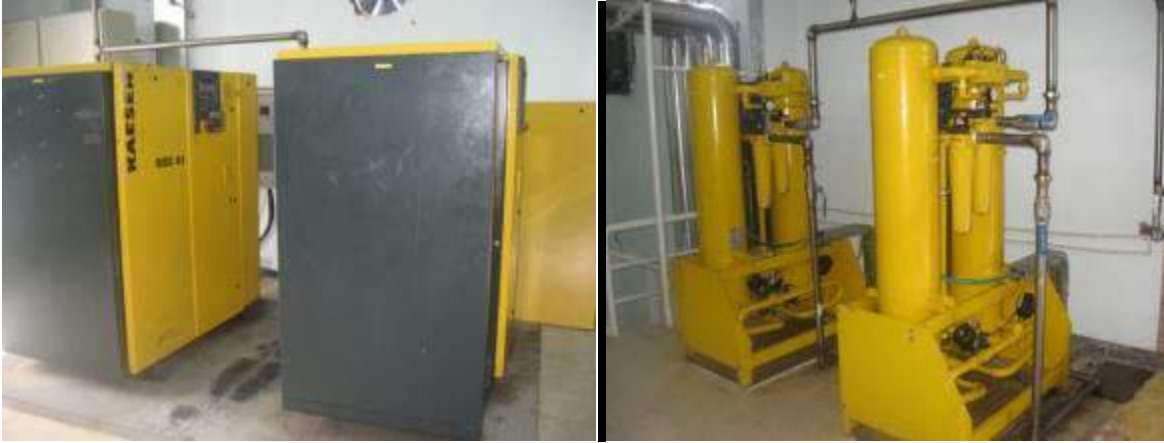
Şekil 12.Hava Kompresörleri ve Hava Kurutucuları
