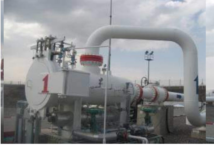
Şekil 3. Filtreleme Sistemi (Siklon ve Ayırıcı-Separatör Filtreleri)
