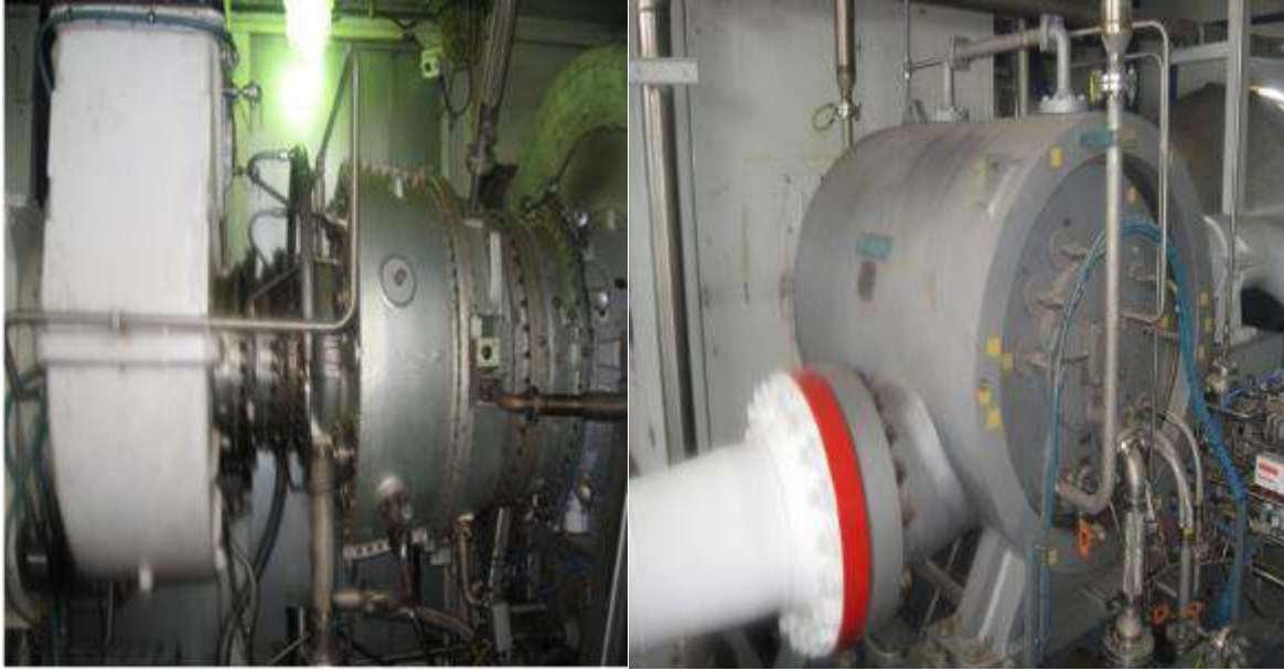
Şekil 4. Gaz Türbini /Gaz Kompresörü
